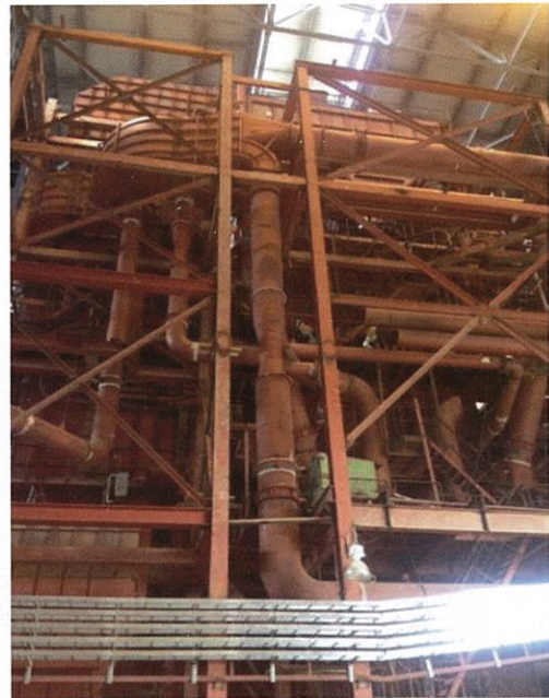
На фото: Паровой котел E-550-13,8-560КТ
